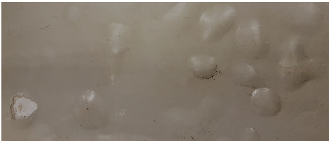
Figur 7.8 Epoxigolv som applicerats på dåligt rengjorda ytor och hög fukthalt i underlaget kan få blåsbildning med upp till 100 mm stora blåsor (foto: M Theorin).
